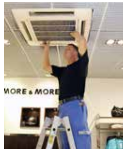
Instandhaltung von Klimaanlagen
